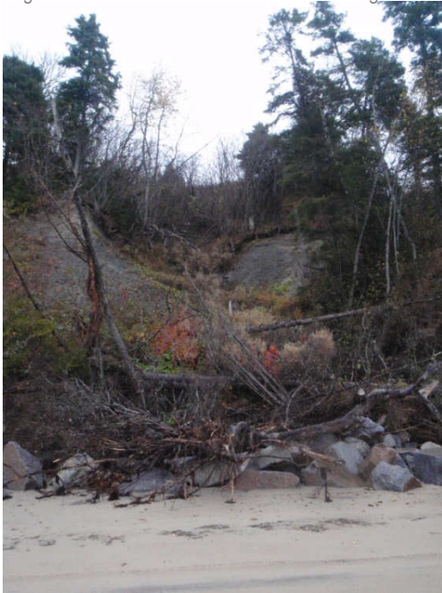
Figure 26: Affaissement du terrain du plateau
