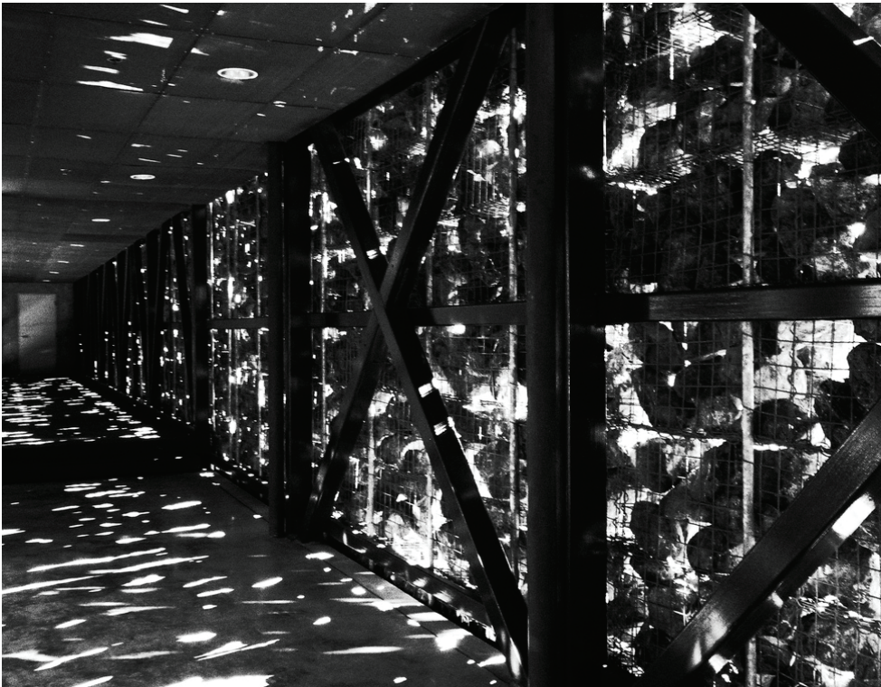
photo 28: Perméabilité du parement de basalte.
